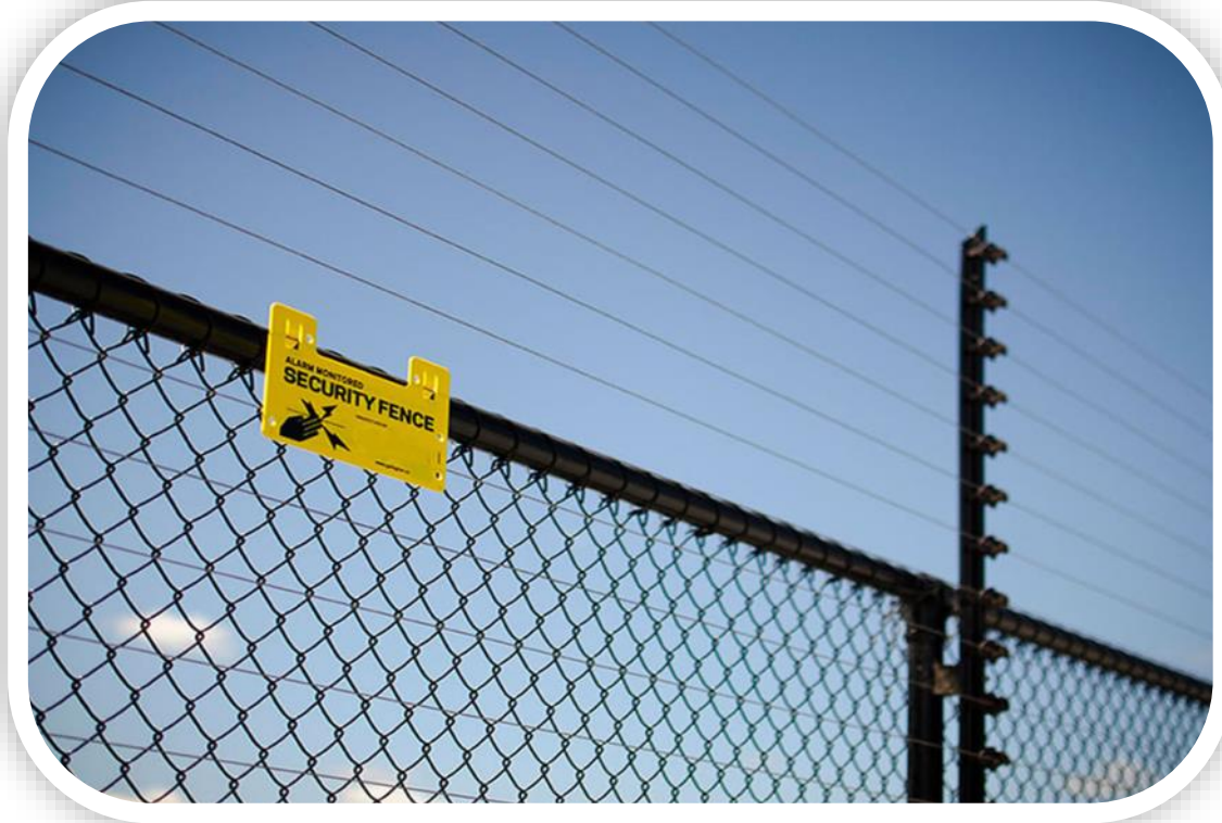
RR-CERC02. Mantenimiento de cerco electrico por metro
