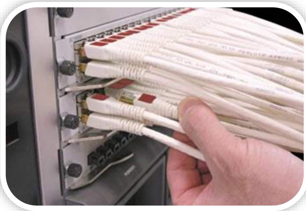
RR-IDENEXTCENTRAL. Identificación de extension de central en panel de conexiones y puestos (2 equipos)
